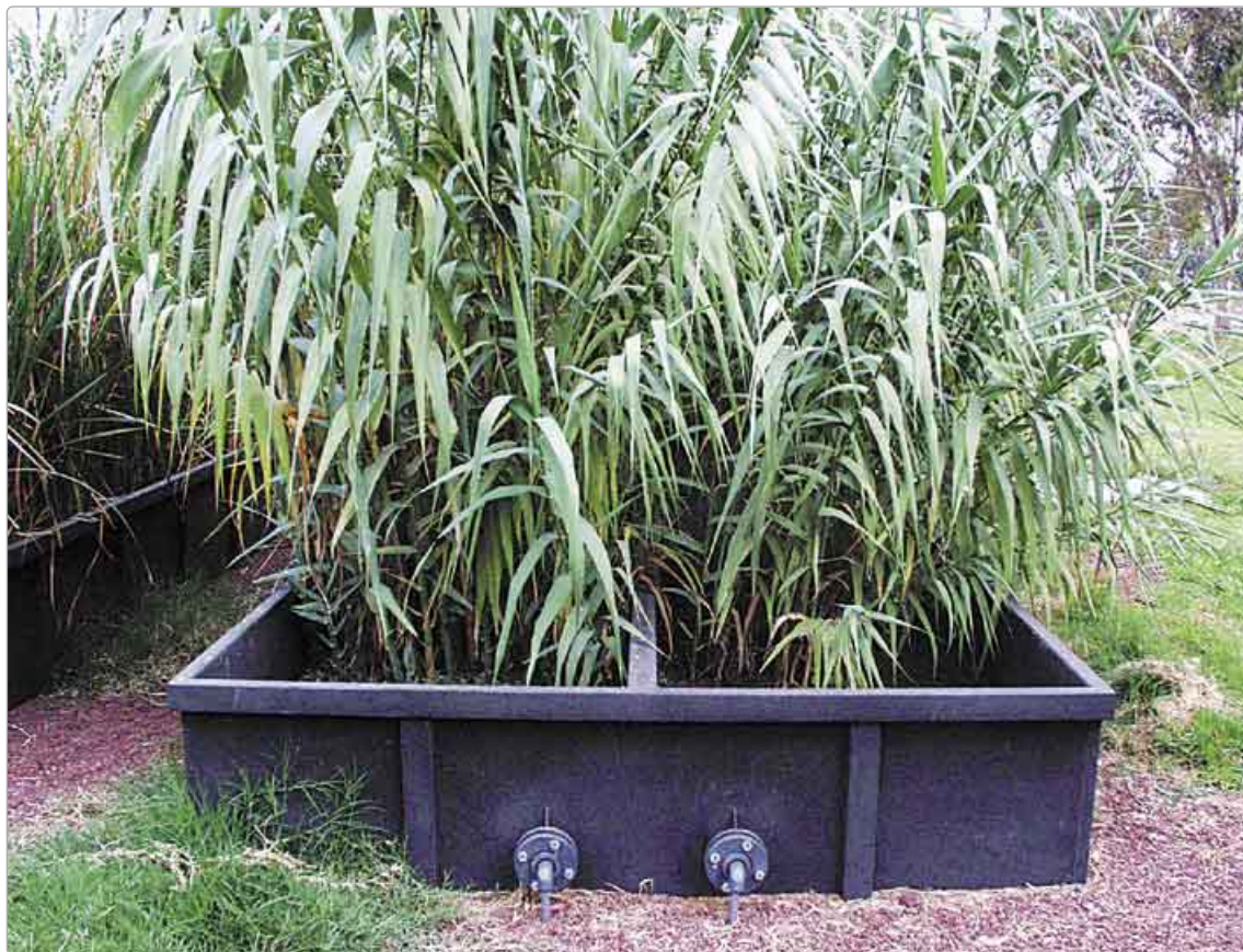
In das Horizontalbeet wird durch Rohre das Abwasser eingeleitet, das dann über ein geringes Gefälle die verschiedenen Felder von Wurzelschicht und Filtersubstrat durchläuft. (Xochitla); (Quelle: Umweltschutz Nord GmbH)
