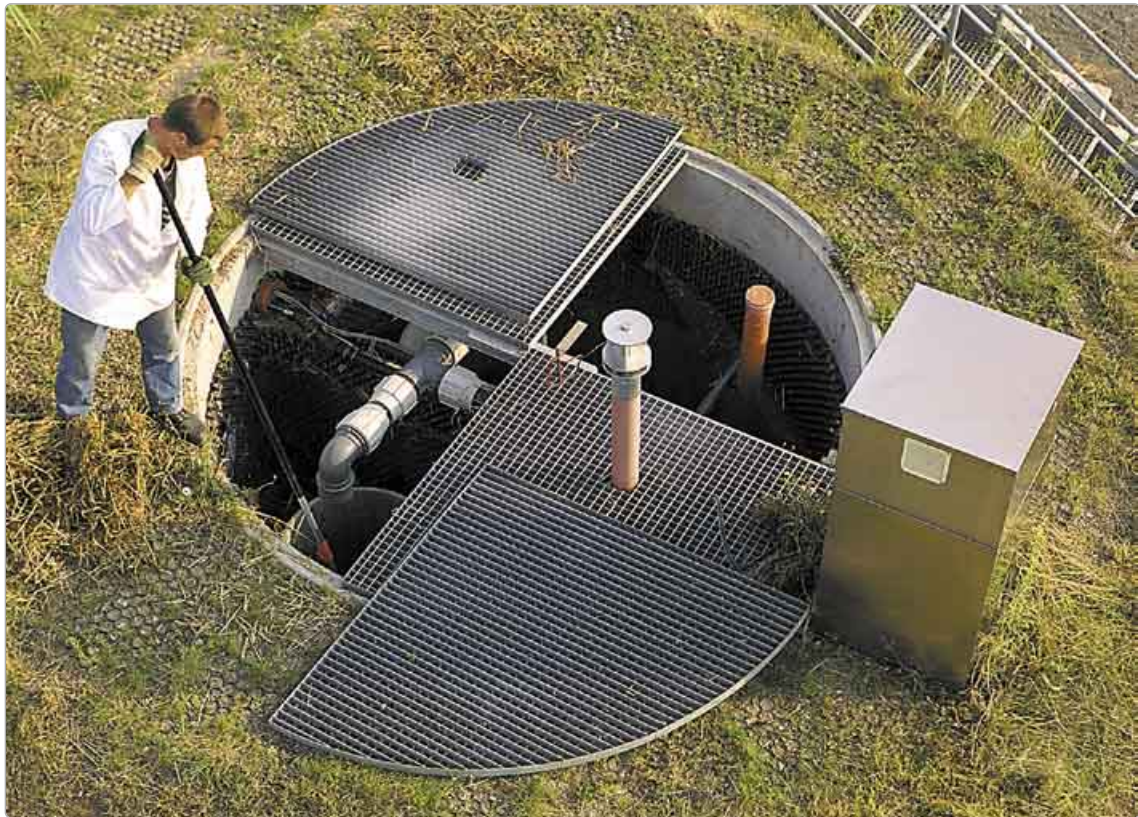
In Langenreichenbach, der Schwesteranlage von Xochitla, werden Rottefilter in der Vorklärung eingesetzt: Stroh filtert die Feststoffe aus dem Abwasser. Anschließend wird das verbrauchte Filtermaterial kompostiert. In Xochitla hingegen setzen sich die Feststoffe in einer Zwei-Kammer-Grube ab – der anfallende Schlamm wird entsorgt. (Quelle: André Künzelmann, UFZ)
