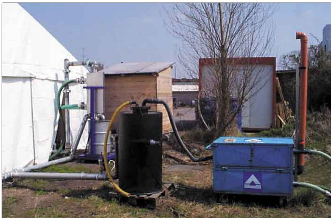
Bild 9a und b: Für den Bau der Anlage wurden neben der Radiowellen-Technik (9a) herkömmliche Komponenten zur Bodenluftabsaugung (9b) verwendet (Quelle: UFZ, Sektion Sanierungsforschung).
