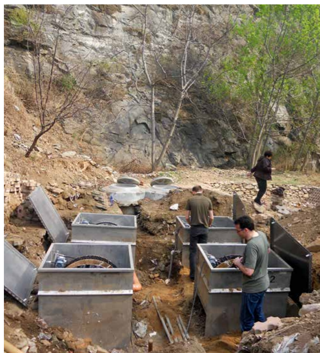
Abb. 18: Installation der Rotationstauchkörper (RTK)-Kläranlage in Taoyuan. → Foto: Beijing Water Authority
