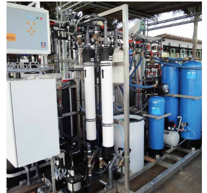
Abb. 69: Pilotanlage zur Abwasserbehandlung am Lago Paranoá, Brasilia (IWAS AGUA DF). → Foto: S. Gronau, Universität der Bundeswehr, München
