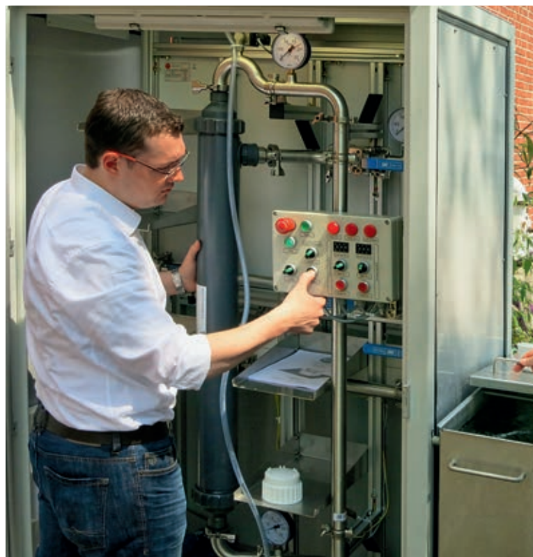
Inbetriebnahme des Konti-CUF-Systems im Berliner Wasserwerk Friedrichshagen
