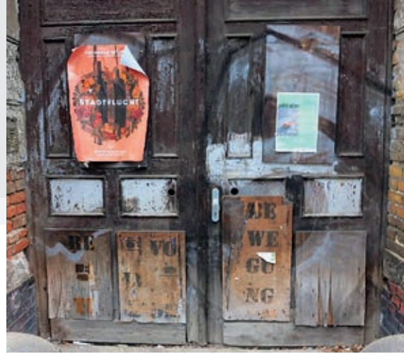
Infolge des demografischen Wandels kommt es zu Wohnungsleerständen und zur Unterauslastung von Infrastrukturen
